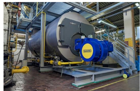
Flammrohrkessel mit Saacke-Brenner (Quelle: Saacke)
